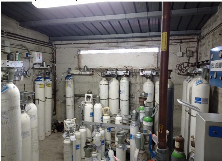
Piano -1, Area Gas Medicali, Ospedale di Stato, 2023.
